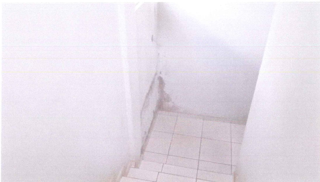
IMAGEM 13 – ESCADA COM INFILTRAÇÃO NAS PAREDES
