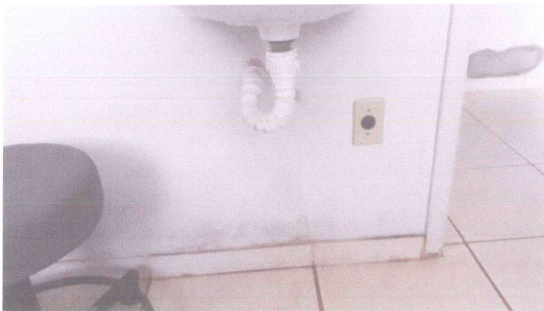
IMAGEM 21 – PAREDE DA UNIDADE COM INFILTRAÇÃO
