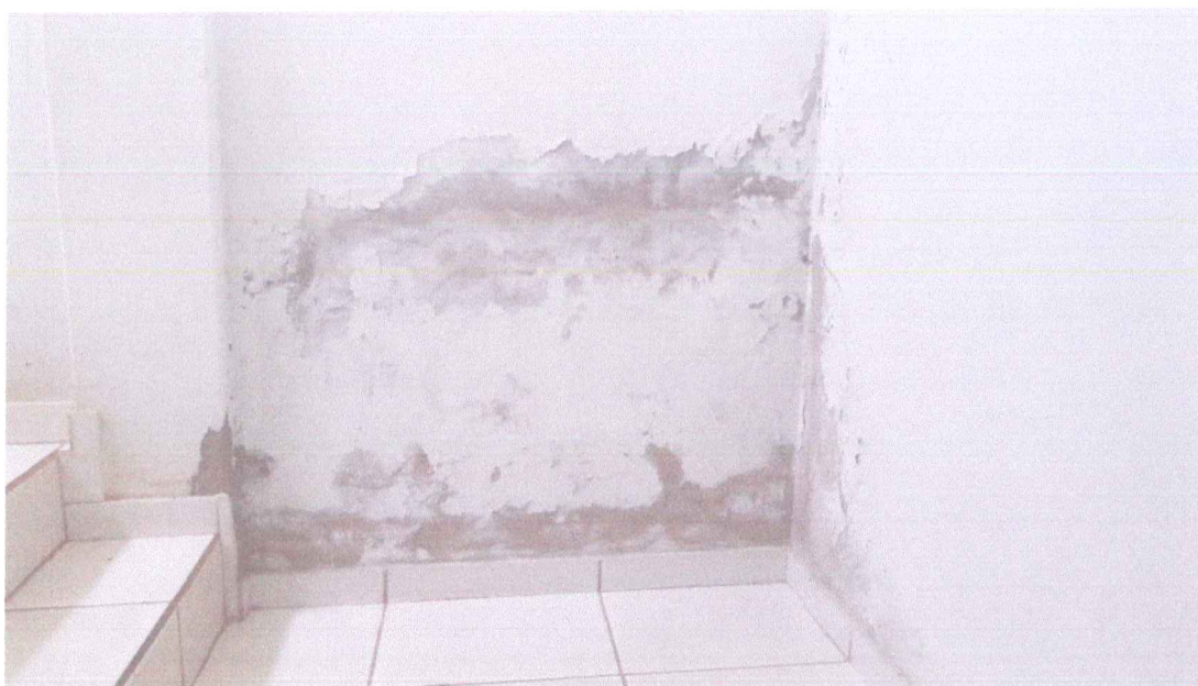
IMAGEM 9 – PAREDE DA UNIDADE COM INFILTRAÇÃO, CORROMPENDO O REVESTIMENTO
