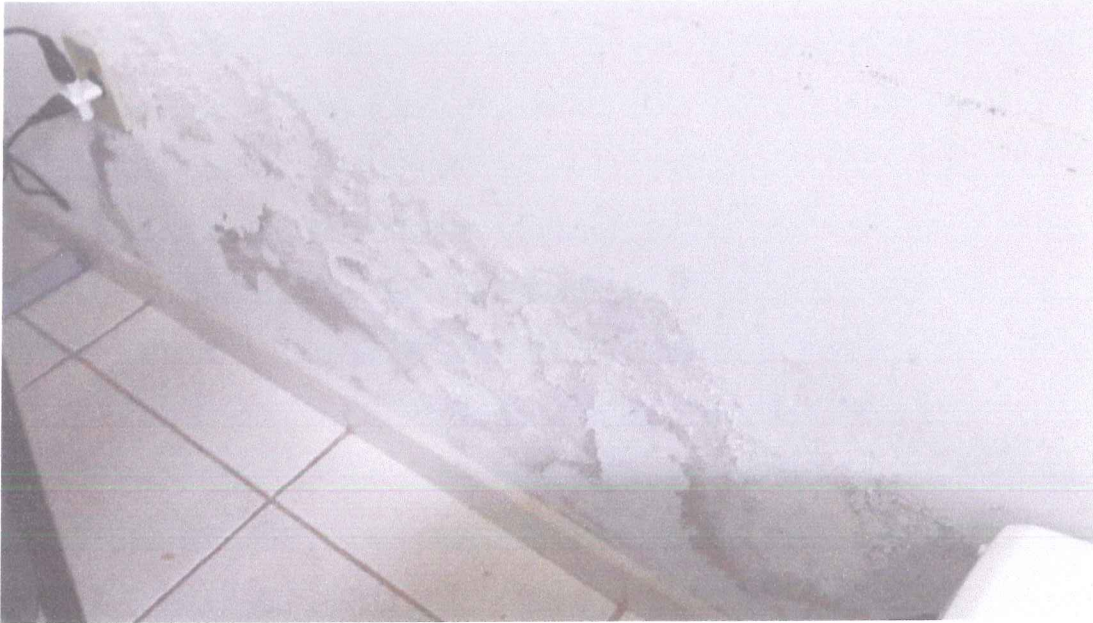
IMAGEM 6 – PAREDE DA UNIDADE COM INFILTRAÇÃO, CORROPENDO O REVESTIMENTO.
