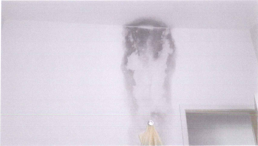
IMAGEM 22 – PAREDE DA UNIDADE COM INFILTRAÇÃO
