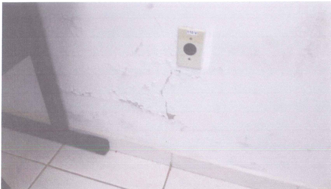
IMAGEM 8 – TOMADA PARA TUG'S DANIFICADA.
