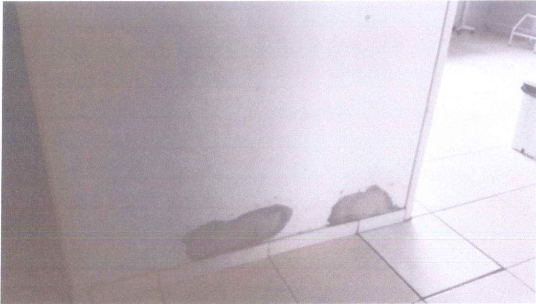
IMAGEM 18 – LOCAL COM INFILTRAÇÕES JÁ TRATADAS
